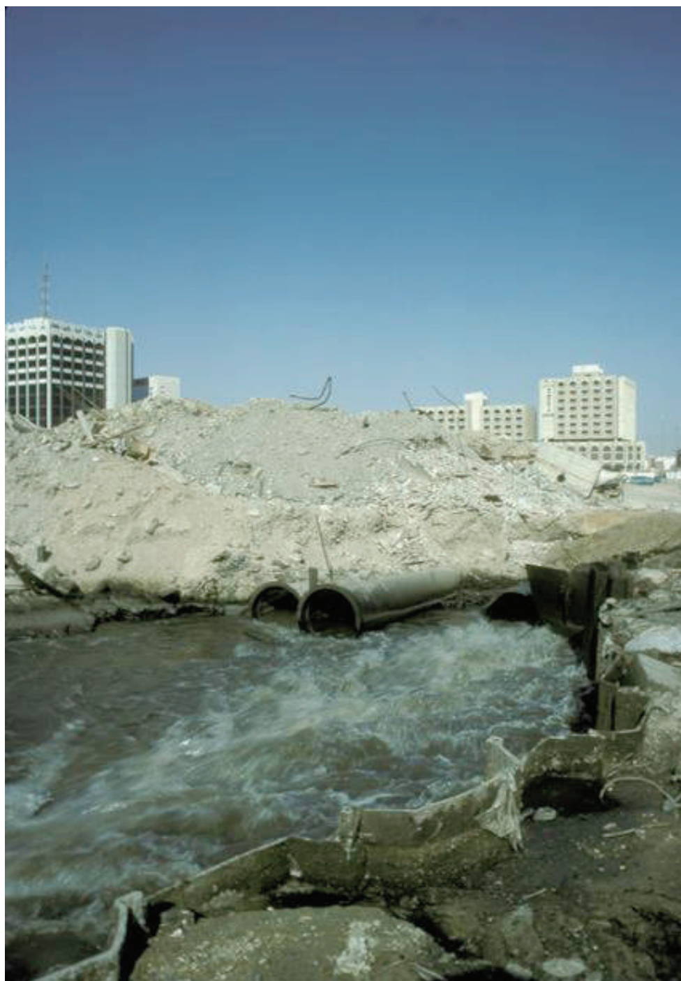
Emissaire de rejets des eaux usées dans le début des années 1980
